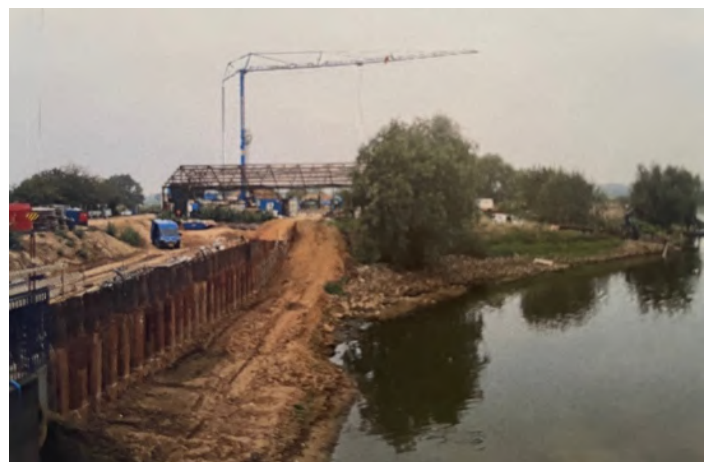
2018/2019 Bouw van de vispassage met op de achtergrond de afbraak van onze oude winterberging
